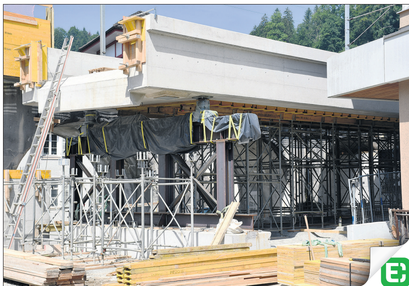
Auf dem Lehrgerüst ruht die neue Brückenplatte aus Stahlbeton. Sie wird in den nächsten Wochen den Bogenviadukt in Wolhusen ersetzen. [Hinter diesem Bild verbirgt sich eine Bildergalerie, die mit der Extra-App aktiviert werden kann.]
